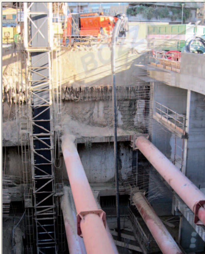
Figura 7 - L'aspirazione arriva sino a 30 m di profondità
