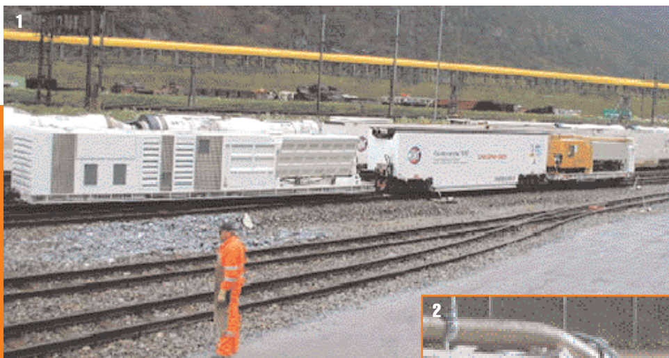
1. Veduta del cantiere di escavazione del tunnel del Gottardo, con i moduli dell'escavatore a risucchio e i container per il materiale
