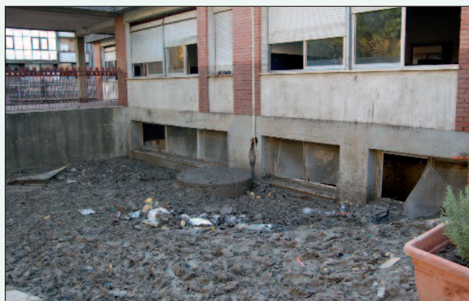
Figure 6 - L'accumulo di detriti nei piani bassi delle abitazioni
