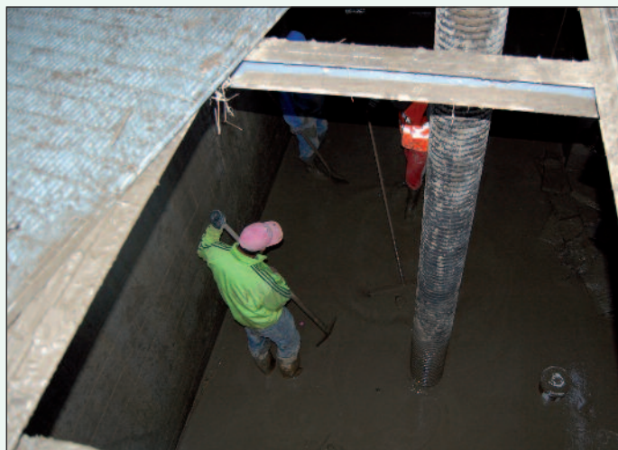
Figura 4 - Il tubo di aspirazione per velocizzare le operazioni di pulizia
